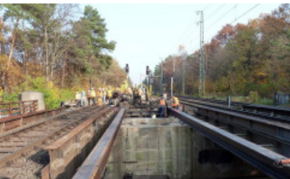
Vorbereitung des Einbaus der Gleishilfsbrücke über den Fischerhüttenweg (07.11.2011) Fotos: DB ProjektBau GmbH
